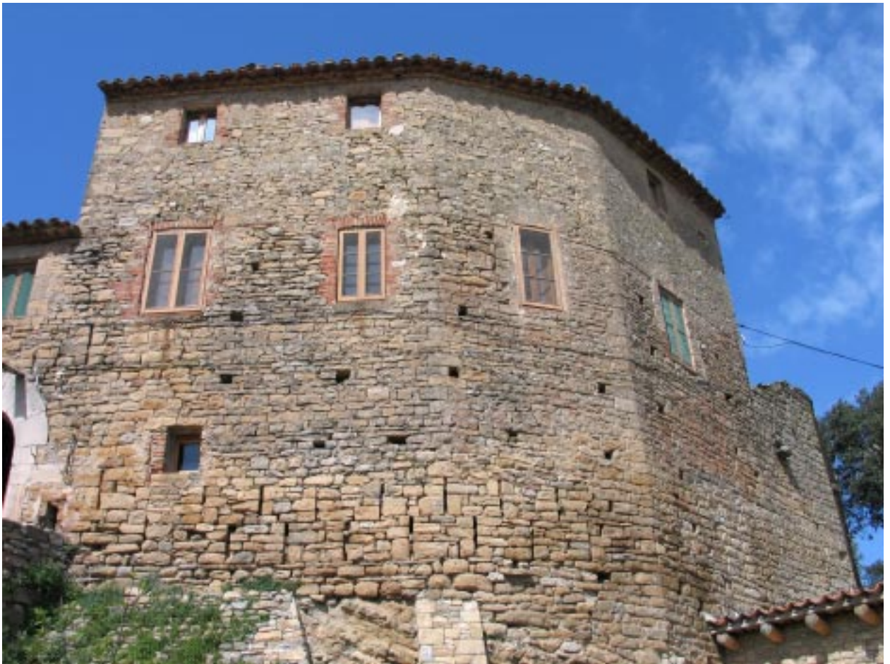
Muralla del castell, actualment formant part de l'habitatge existent. Foto de Jordi Gironès.
